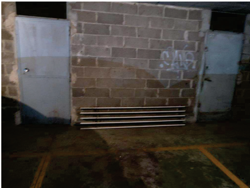
ARRETRAMENTO POSTO MACCHINA PER ACCESSO ALLE CANTINE PRIVATE
